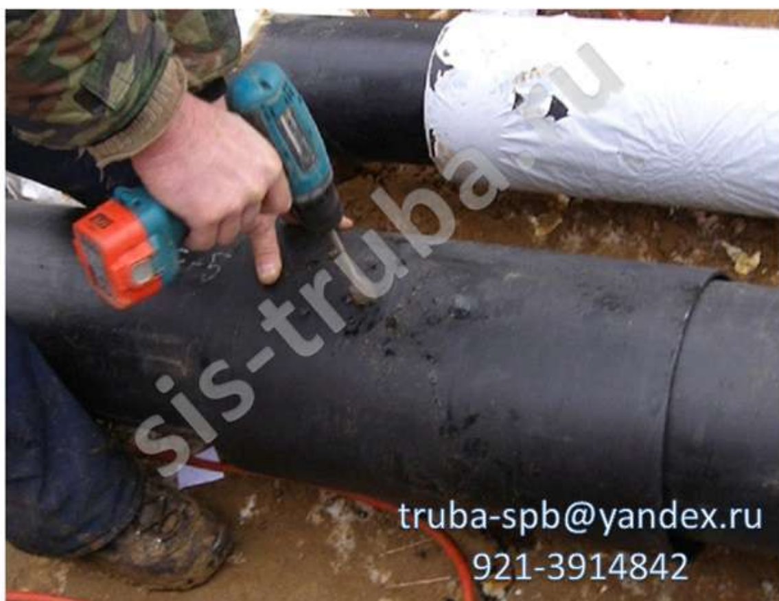
3.7. Прогреть подготовленные поверхности оболочек с обеих сторон от стыка мягким пламенем пропановой горелки до температуры 30^{\circ}\text{C} - 50^{\circ}\text{C} . На теплую поверхность оболочек по периметру наклеить адгезивную или мастичную ленту, отступив от рисок 10-15мм. Нахлест адгезива или мастики в месте соединения 10мм. После чего удалить
